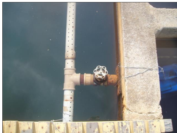
Figura 17 Captação de água para os filtros
