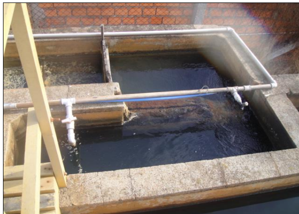
Figura 14 Floculador onde é adicionado carvão ativado
